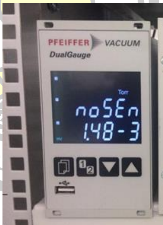
รูปที่ 3.13 Pressure monitor
